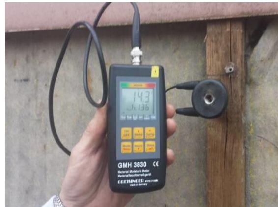
Holzfeuchtegehalt der Unterkonstruktion 14,3%
